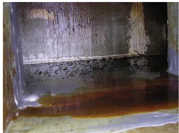
Typische Fett- und Ölablagerungen in einem Küchenabluftkanal
